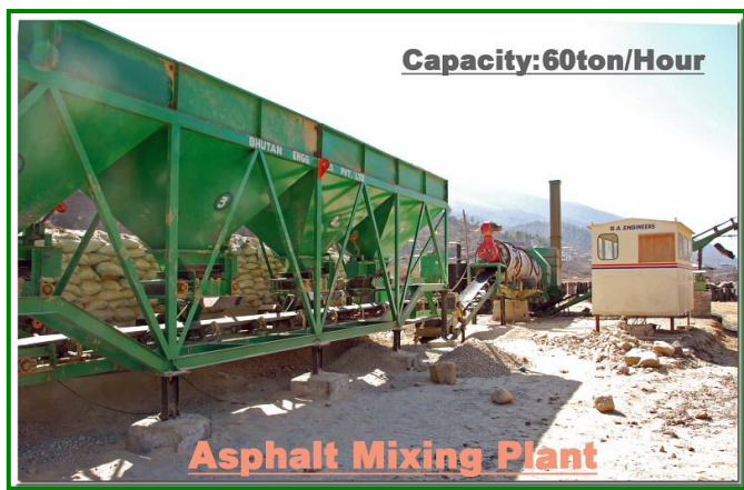
写真7-4 ミキサープラントの材料配合ビン
