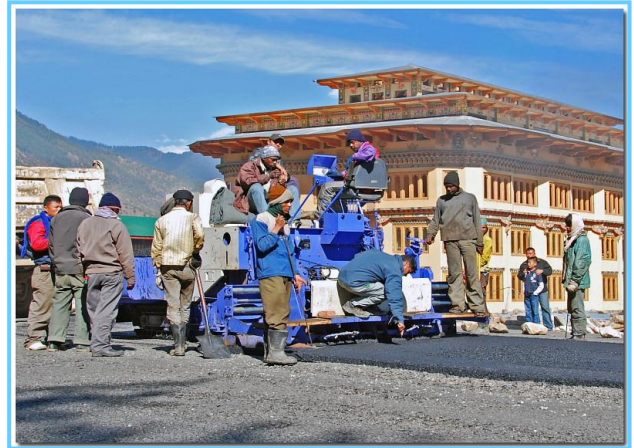
写真5-3 舗装施工監督は舗装厚を均一にするために懸命に厚さを測定している。
