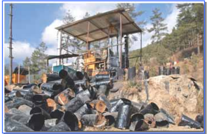
写真5 - 1 日本政府無償資金協力で調達された小型アスファルトプラント(能力：10 トン/時)
